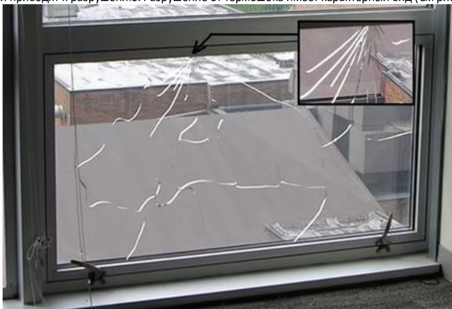
Рис. 1. Разрушение стекла от термошока
