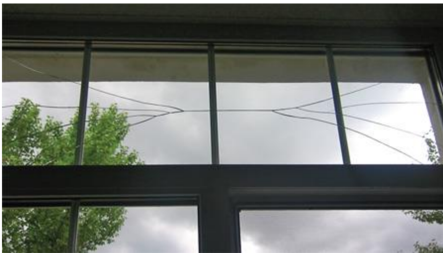
Рис.7 Пример разрушения стекла «бабочка» в пакете (неправильное соотношение сторон)
