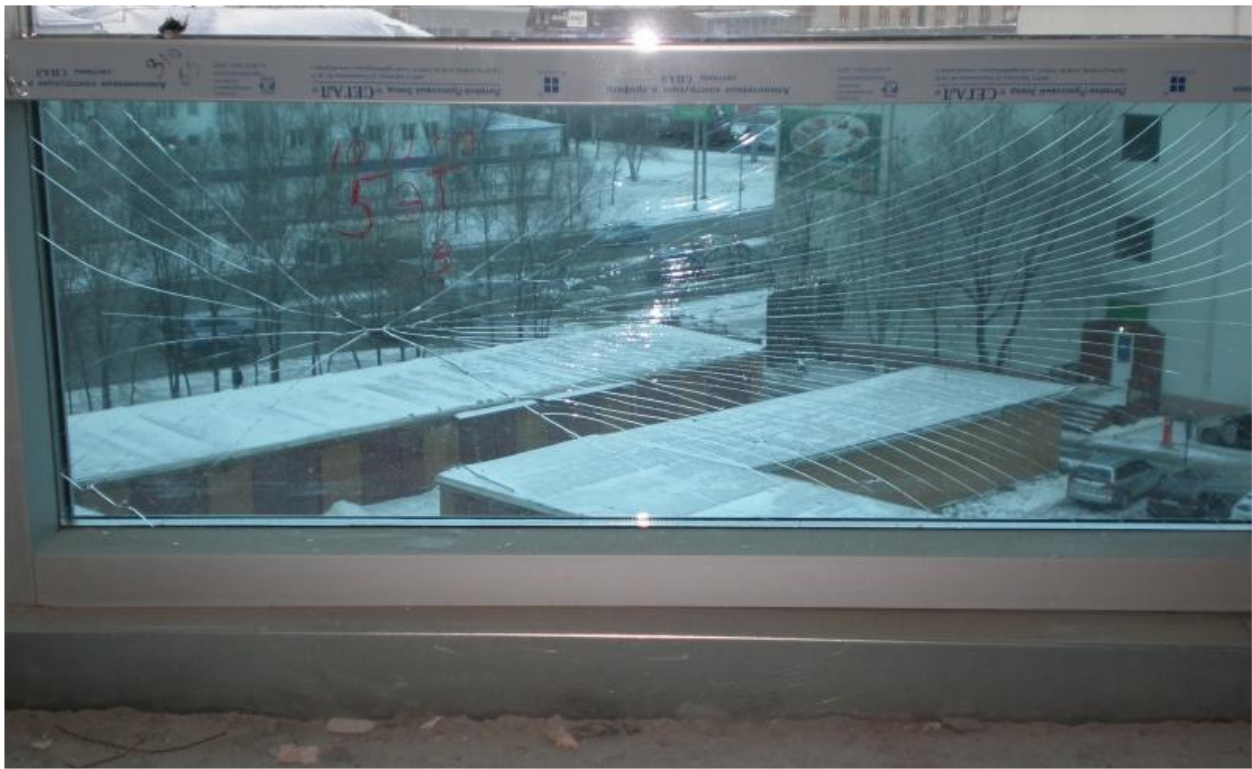
Рис. 6. Пример разрушения стекла в пакете из-за перепада давления и температуры (неправильный монтаж)
